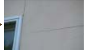
外装のクラック
